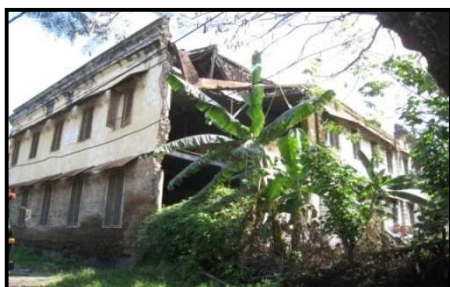
Gbr. Bangunan C runtuh bag. timur-utara.
